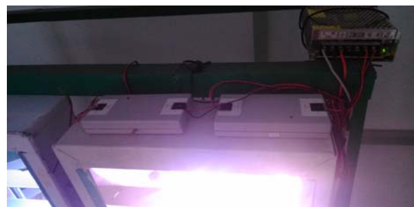
ภาพที่ 5 DC Dimmer Control (ADC) ควบคุมปริมาณแสงและเพาเวอร์ซัพพลาย
