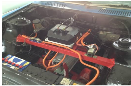
ภาพที่ 10 การติดตั้งชุดควบคุมมอเตอร์ไฟฟ้าและมอเตอร์ไฟฟ้าสมบูรณ์
